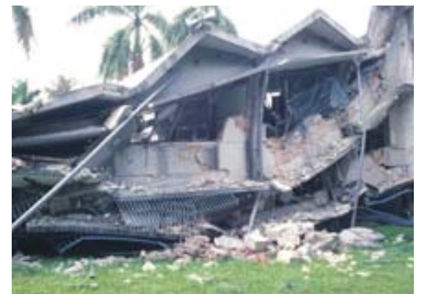
▲集集大地震校舍倒塌情形。（攝影／廖泰基）
